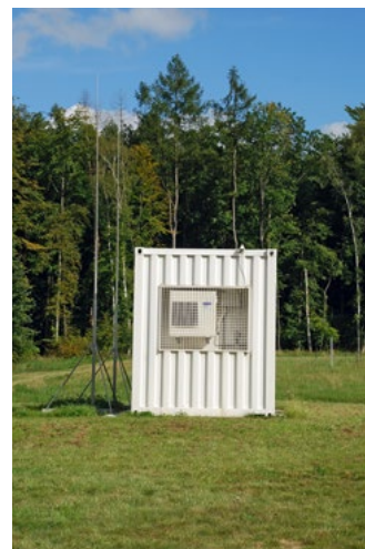
Klimatisierter Container für die Empfänger und die Datenübertragung; die Vertikalstäbe an der linken Seite sind Blitzableiter
