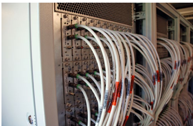
Im Container befinden sich 96 Empfangskarten, die für den Empfang des Low Band oder High Band umgeschaltet werden.
