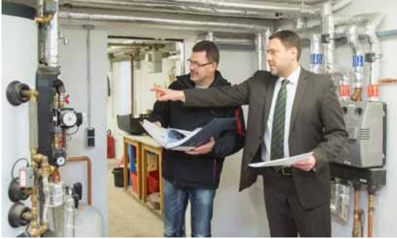
Im Keller der Kita „Tausendfüßler“ ist die Mikro-BHKW-Anlage sauber installiert, und Ruß und Staub gibt es mit Erdgas als Energieträger auch nicht. (li. J. Steinmetz, BM Holzthaleben, S. Fürich, TEAG)
