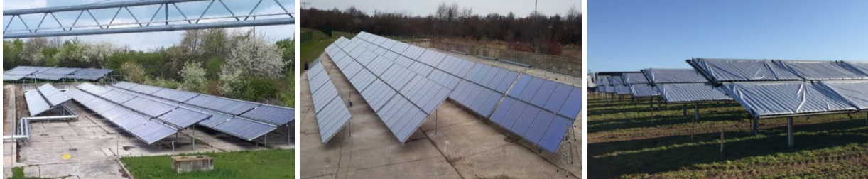
Abbildung 14: Solarthermie-Anlagen in Erfurt und Mühlhausen 77
