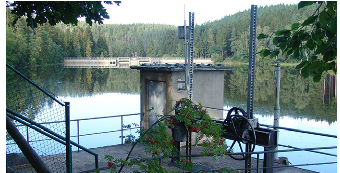
Wisenta-Stausee mit Einlaufbauwerk zum Druckstollen, 2020, Foto: Thüringer Museum für Elektrotechnik e.V.
